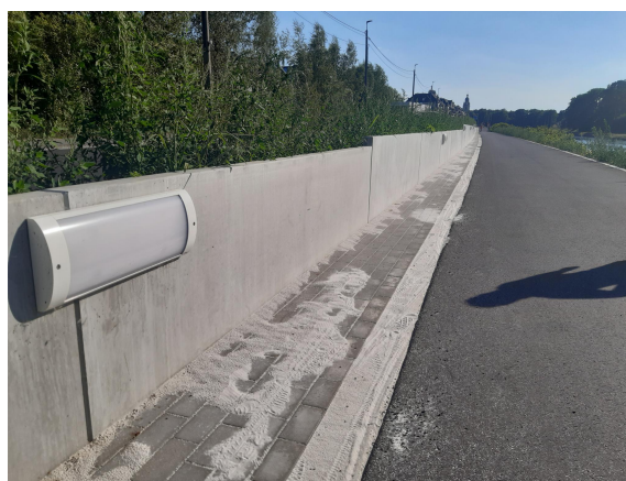
Éclairage discret mais fonctionnel, Hal, Fietssnelweg F20
